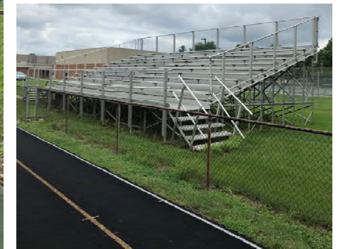
F – No ADA to bleachers
