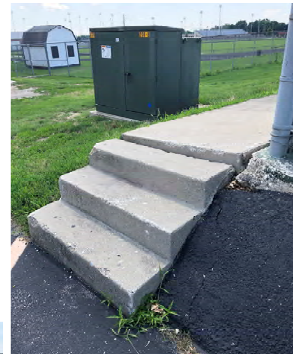
F- No ADA access
